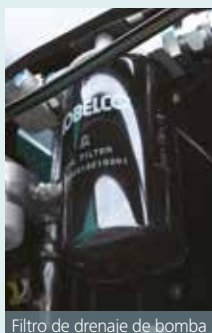
Filtro de drenaje de bomba
